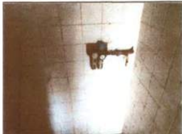
FOTO Nº VISTA SAÍDA AR COMPRIMIDO PISTOLA DE ATORDOAMENTO
