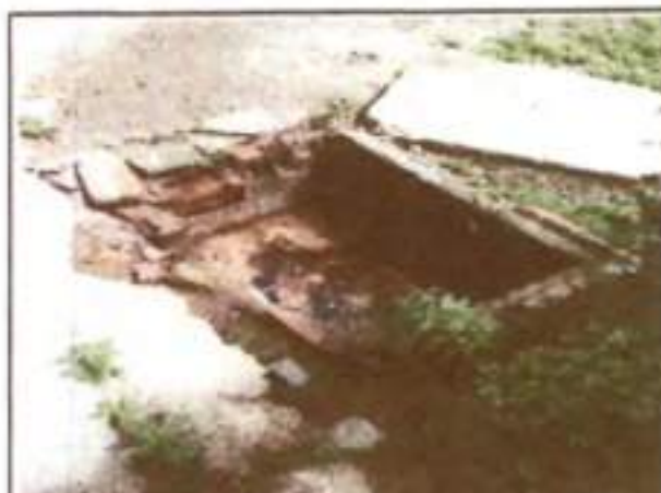
FOTO Nº VISTA CX DE PASSAGEM RESÍDUOS DA LIMPEZA SUMIDOURO CHEIO 20
