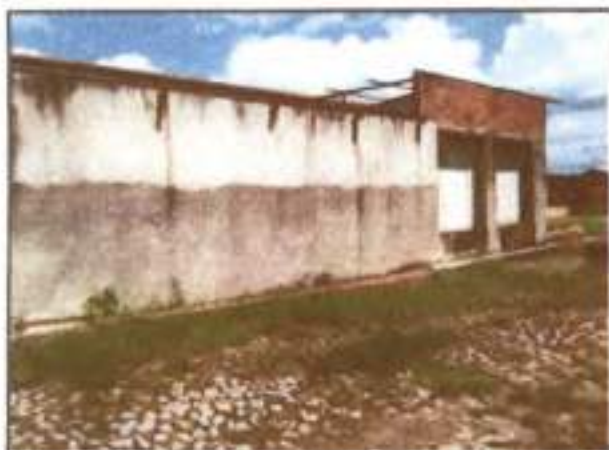
FOTO Nº VISTA LATERAL CÂMARA FRIA
