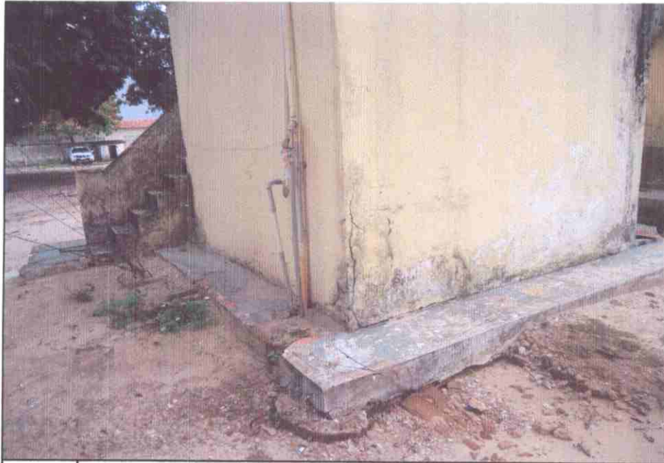
FOTO Nº CALÇADA A RECUPERAR 3 HORIZONTE-CE
