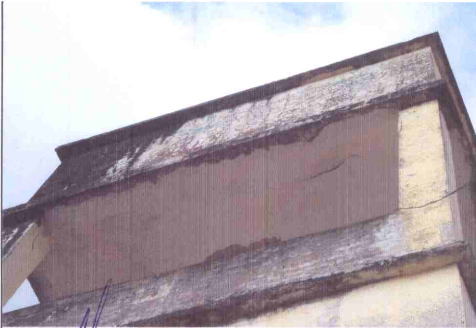
FOTO Nº LAJE A SER RECUPERADA 8 HORIZONTE-CE
