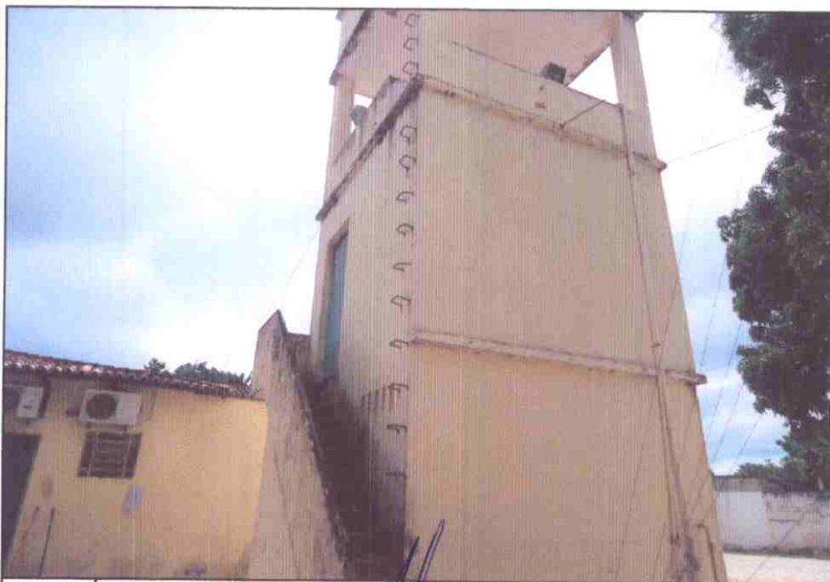
FOTO Nº DETALHE DA ESCADA DE MARINHEIRO A SER SUBSTITUÍDA 4 HORIZONTE-CE
