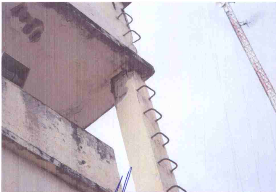
FOTO Nº ESTRUTURA A SER RECUPERADA 6 HORIZONTE-CE
